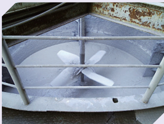
石灰乳调配系统
