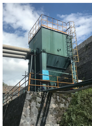
长安选矿厂利用改造后的微孔膜除尘器对二级破碎、筛分工序区域进行除尘，效果良好
