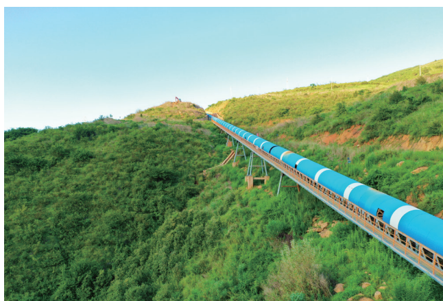
北衙公司露天剥离废石采用半移动式破碎站+胶带运输排废模式，胶带项目各转运站采用洒水降尘系统及全线加装防护罩，最大限度地减少废石在运输过程中产生的扬尘
